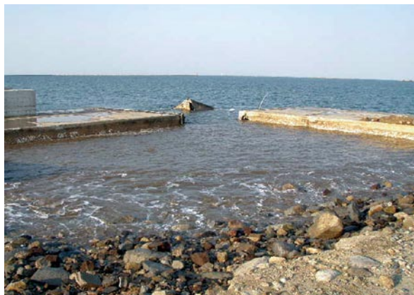
写真-3 隅角部ケーソン被災状況 (3号ふ頭)
