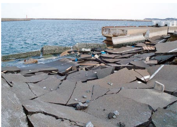
写真-4 ブロック式護岸被災状況 (2号ふ頭)
