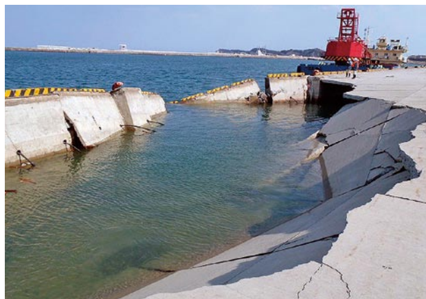
写真-2 タイロッドが破断した岸壁（1号ふ頭）
