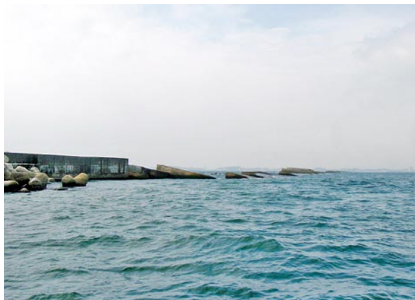
写真-1 沖防波堤被災状況
