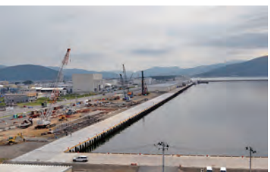
工事名 平成25年度石巻漁港矢板式岸壁災害復旧工事 発注者 水産庁 工期 2013年6月18日～2014年8月29日 施工場所 宮城県石巻市
