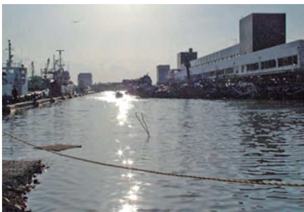
崩壊、沈下により水没した魚市場前の矢板式岸壁
