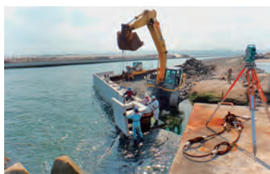
工事名 荒浜漁港北導流堤災害復旧工事 発注者 宮城県 工期 2012年11月27日～2015年3月27日 施工場所 宮城県亶理郡亶理町
