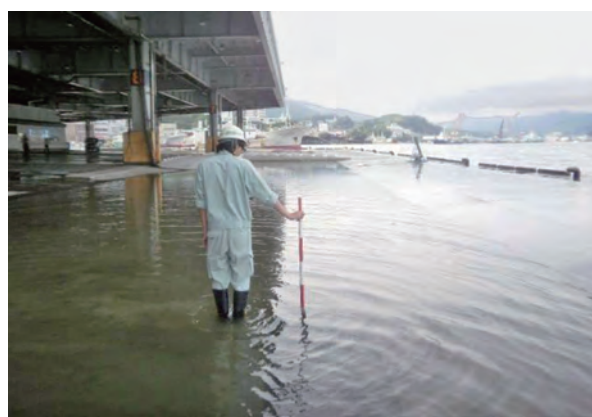
崩壊、沈下により水没した魚市場前の重力式岸壁
