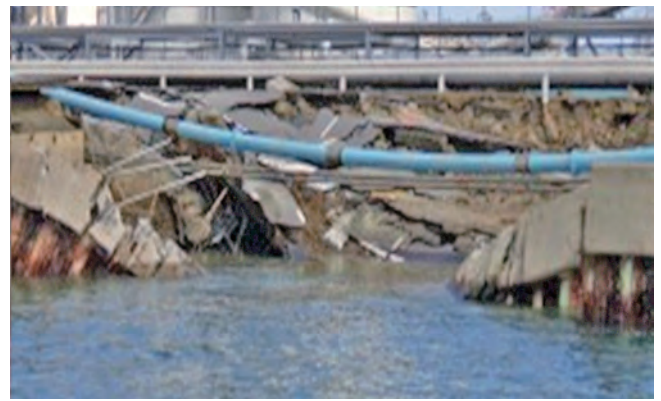
写真-2 地震による護岸の倒壊
