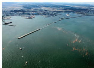
写真-2 八戸港北防波堤被災状況 (撮影：平成23年3月)
