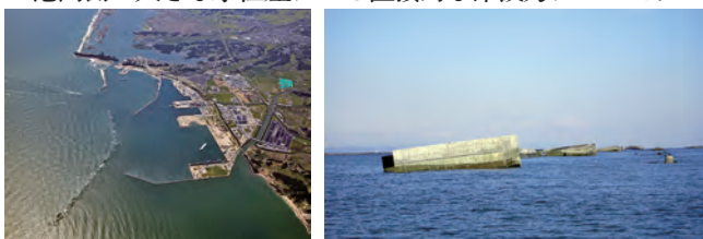
写真-6 相馬港沖防波堤の被災状況（撮影：左・平成 23 年 9 月、右・平成 23 年 3 月）
