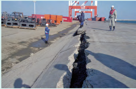
常陸那珂港区北ふ頭外貿の被災の状況
