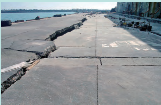
日立港区第1ふ頭1-BC岸壁の被災の状況
