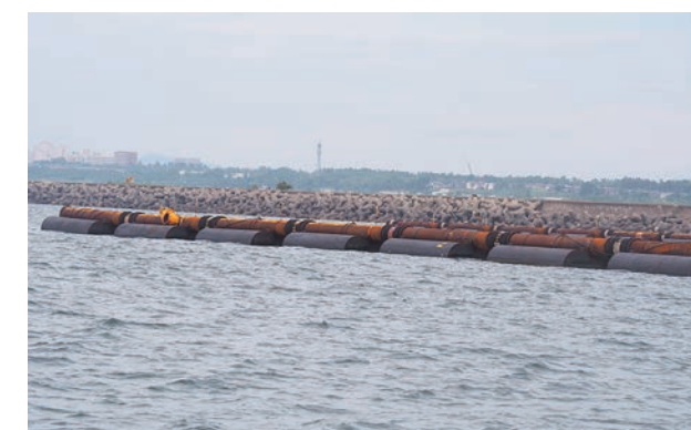
海底に堆積した土砂を排出する排砂管
