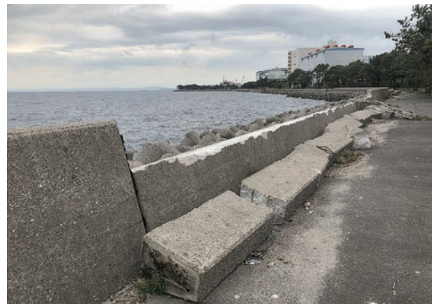
2019年台風15号の高潮・高波による防潮堤破壊(福谷撮影)
