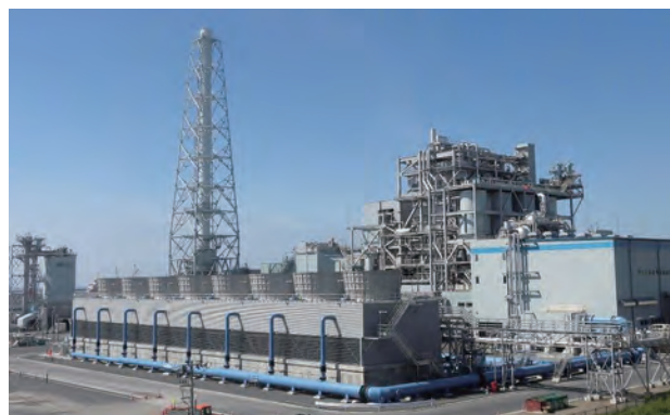
石巻雲雀野発電所
