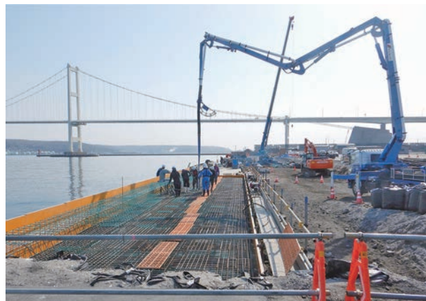
祝津ふ頭岸壁改良工事での上部工コンクリートの打設作業
