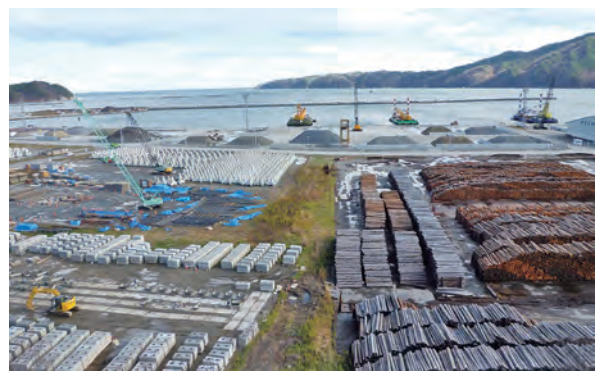
写真-5 復旧資材輸送拠点・作業基地の役割を果たす(宮古港)
