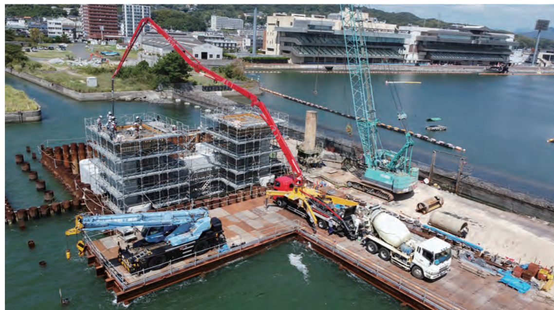
狭あいな作業エリアで躯体建造工(水門本体コンクリート打設)と取り付け護岸工(先行削孔)を同時に進めた
