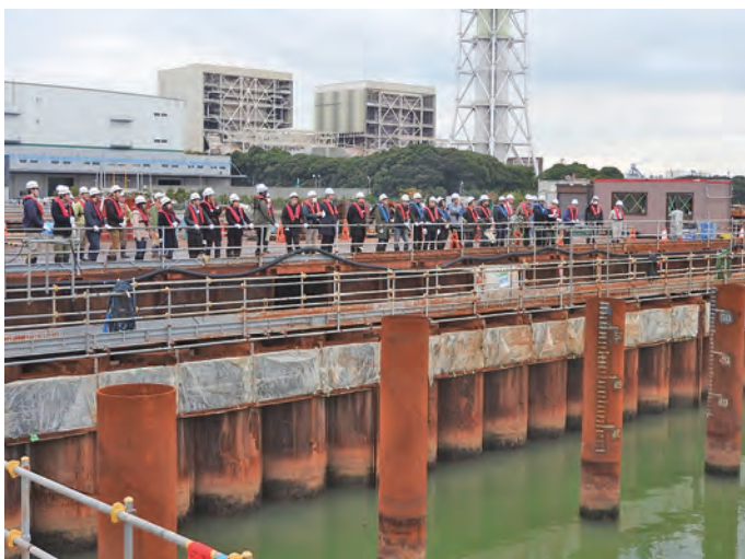
潜水士による大組支保工の架設準備を見学する学生たち
