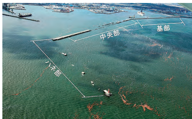
北防波堤の被害状況
