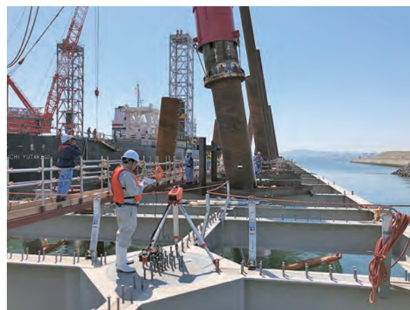
写真-5 PDM(Pile Driving Monitor) - 打撃杭変位の自動読取り装置 - の活用状況
