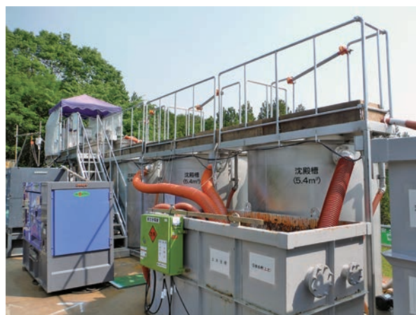
写真-2 泥水処理プラント
