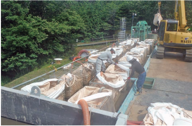
写真-3 脱水処理設備
