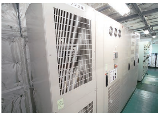
写真-2 蓄電システム
