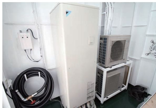
写真-9 エコキュート
