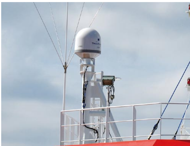
写真-9 VSAT アンテナ
