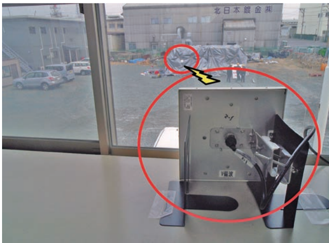
写真-4 事務所と現場との無線LANアンテナ
