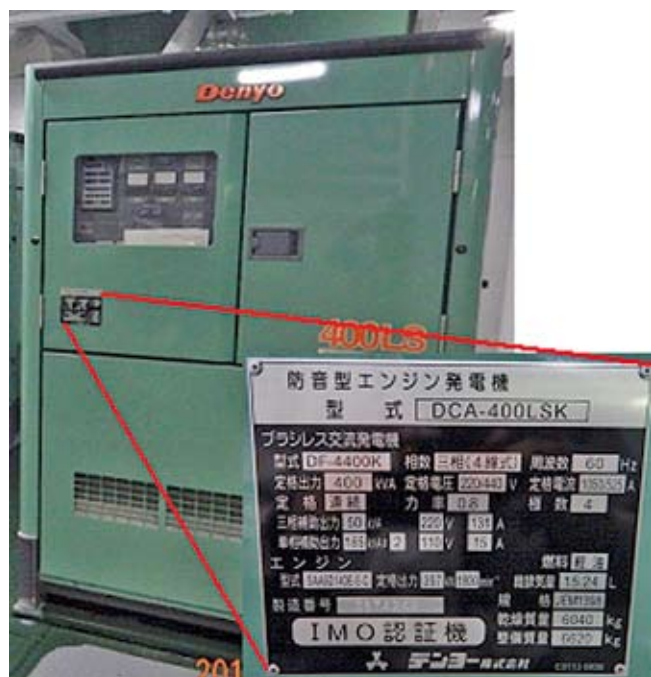
写真-2 主発電機とIMO認証機の銘板
