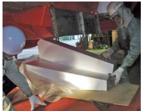
写真-5 余水排水装置(発泡スチロール)
