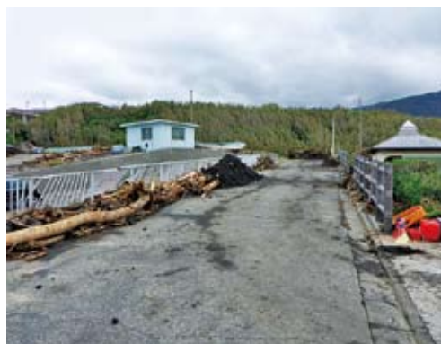
写真-5 転落防止柵の損壊状況
