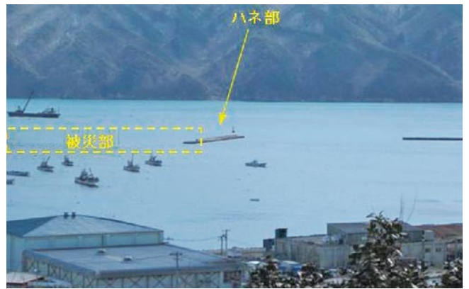
写真-6 出崎防波堤(③工事)の被災状況
