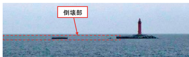
写真-1 八太郎地区北防波堤(ハネ部)の被災状況
