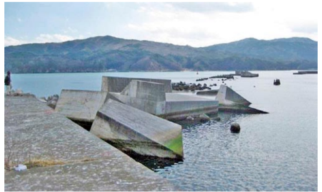
写真-7 神林地区南防波堤(⑥工事)の被災状況
