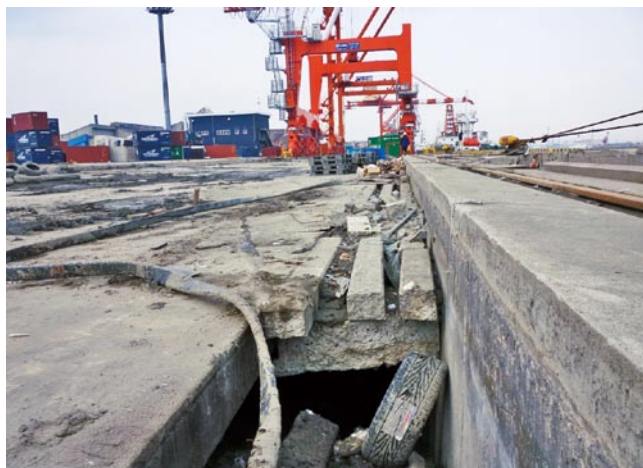
写真-4 クレーンレール基礎上部損傷状況
