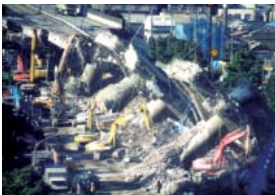
写真1-1 阪神淡路大震災の被災状況 阪神・淡路大震災記念 人と防災未来センター 提供
